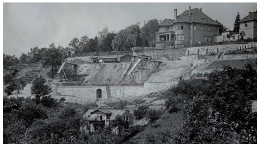
Baustelle für den »Terrassengarten Am Sonnenhang« Foto: Kammeyer-Archiv Hochschule für Technik und Wirtschaft (HTW)
